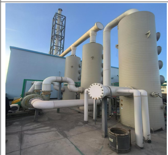
废气净化设施
